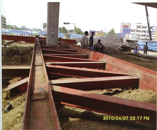
รูปที่ 14 โครงสร้างถักค้ำยันต่อม่อสะพานเดิม
